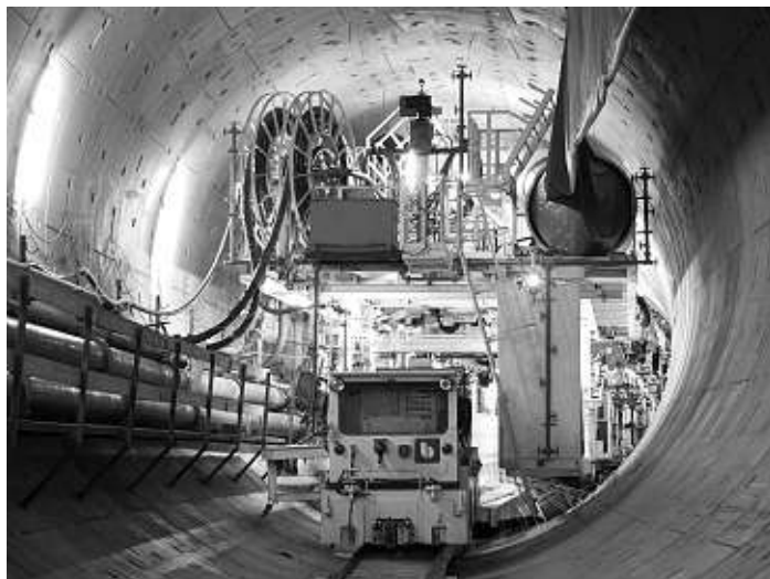
Tuborine wird die gewaltige Bohrmaschine genannt, die den größten Teil des Tunnels für die Wehrhahnlinie im unterirdischen Schildvortrieb errichtet. Foto: Stadt Düsseldorf
